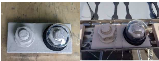
(a)試験開始時 (b)1年経過時 図-5 ケース2の暴露状況
