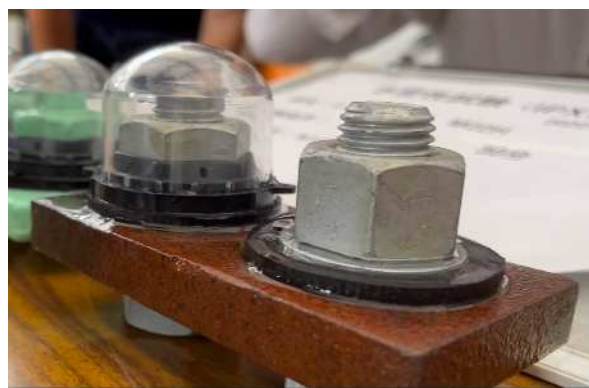
(b) 腐食鋼板(無塗装ボルト)
